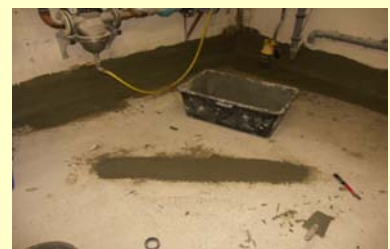
Abgedichteter Riss in Bodenplatte
