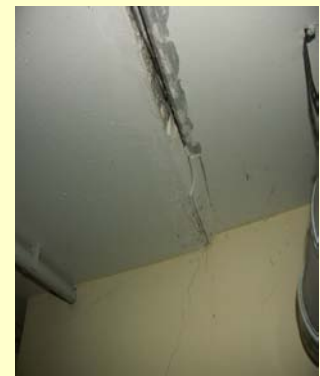
Setzungsschaden an Dehnfuge
