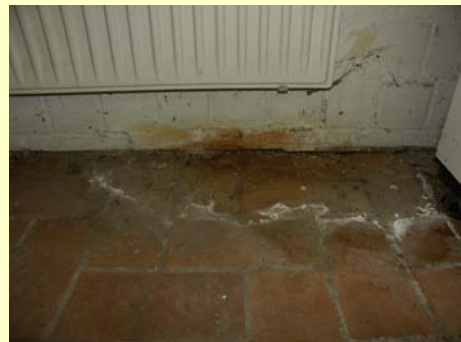
Wassereintritt am Fußpunkt
