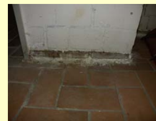
Salzausblühungen im Fußpunkt
