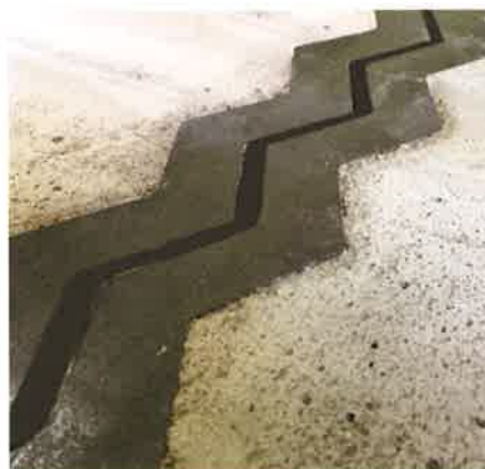
Fugenaufweitung nach dem Schwinden
